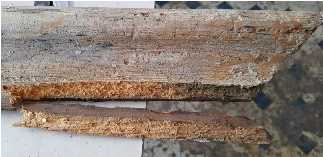
Fotografia 31 Fragmenty ramy po usunięciu przemalowań. Drewno silnie zniszczone przez owady, praktycznie rozsypuje się.
